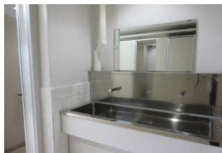
各トイレ内の手洗いは自動水栓になりました。
