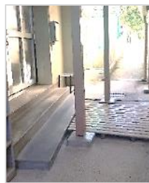
体育館入り口の階段の段差
