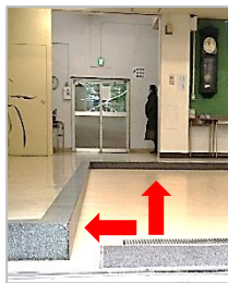
三年昇降口内の段差
